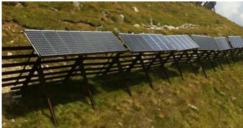
Beispielbild PV-Anlage an Lawinverbauung, Quelle: enalpin.com
