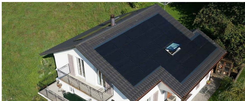
Indachanlage (z.B.: System Arres)
